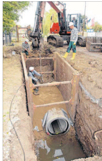
Durch diese Rohre in der Tiefe fließt künftig das Wasser von der Ilse in die Mühlenilse und als Graben durch die Altstadt.
