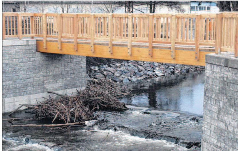
Schwemmgut hat sich an den großen Steinen der Sohlgleite und dem Brücken-Widerlager angestaut.
