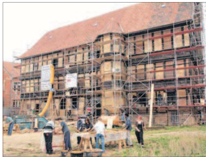
Baustellengewimmel während des Bildungsseminars. Die meisten Fachfelder der Nordseite sind jetzt verstrichen. Foto: Mario Heinicke
